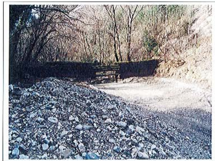
Plage de dépôt du Malsouche en partie comblée par les matériaux. Source : Alp'Géorisque, le 22 mars 2006
