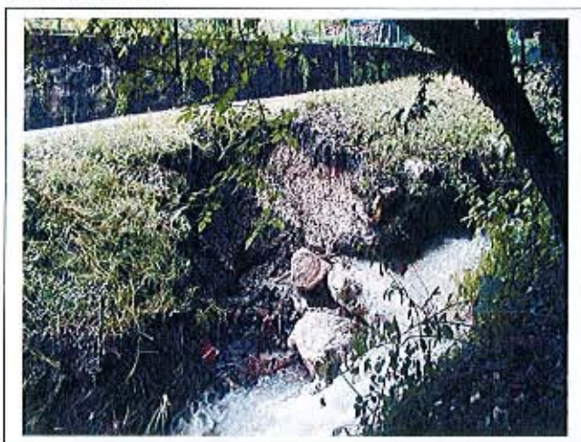
Affouillement du torrent suite à la crue de juin 2002.
