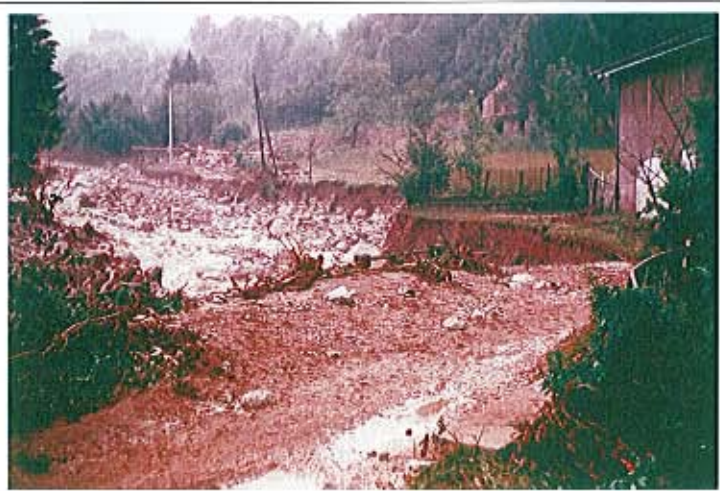
Erosion de berge en rive gauche du torrent de la Roize, à l'amont du pont de Gigot suite à la crue de juillet 1971. la route et la culée du pont en rive gauche ont été totalement emportées.
