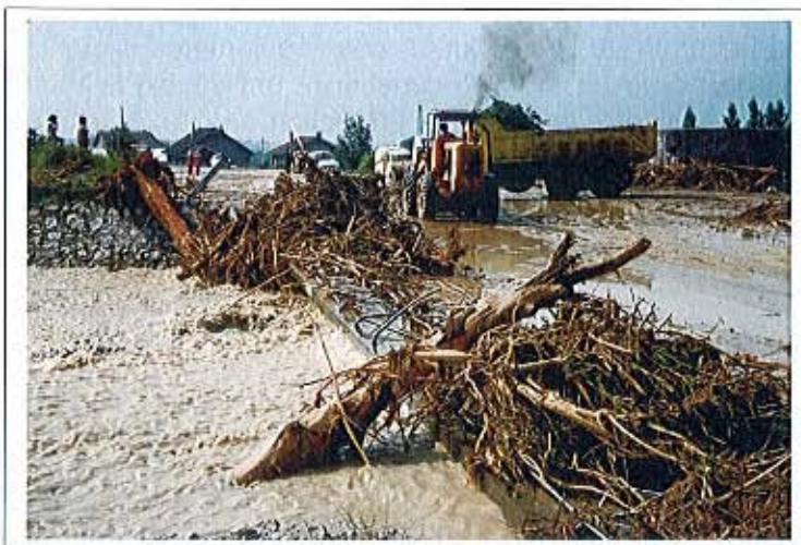
Pont de la route nationale 75 pendant la décrue, en juillet 1971. Noter l'obstruction presque totale du pont par les matériaux (cailloux et flottants)
